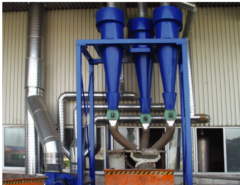
Absauganlage mit drei Hochleistungszyklonen und einer Presseinheit zur Staubentsorgung direkt in einen Container (Staubanfall 12 Tonnen am Tag)
