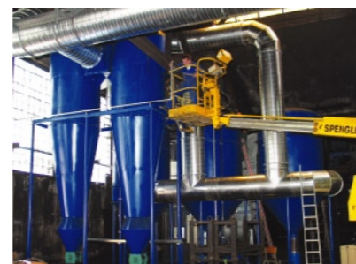
Hochleistungszyklone als Funkenabscheider mit Filterzyklonen - Volumenstrom 70.000 m 3 /h
