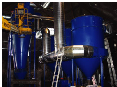
Absauganlage bestehend aus Filterzyklone und Doppelhochleistungszyklone.
