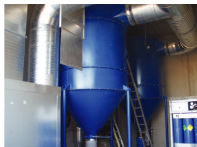
Zwei Filterzyklone und ein schalldämmter Radialventilator mit einem Nennvolumenstrom von 45.000 m 3 /h.
